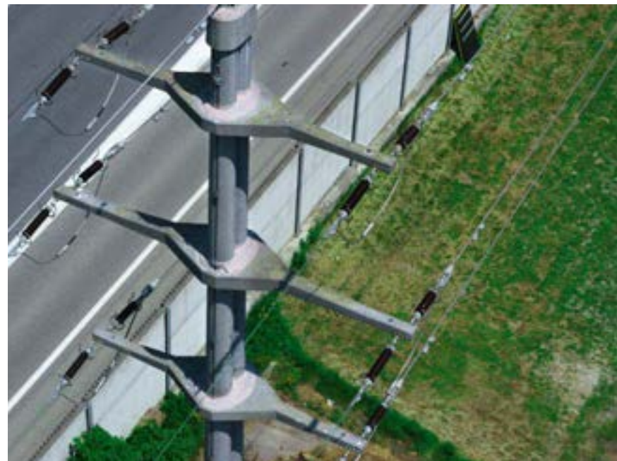
Auf den Bildern, die die Kamera an die Bodenstation liefert, sind Schäden gut zu erkennen.
