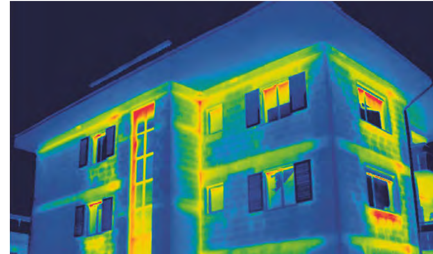
Undichte Stellen in der Fassade können für Wärmeverlust und hohen Energieverbrauch sorgen.
